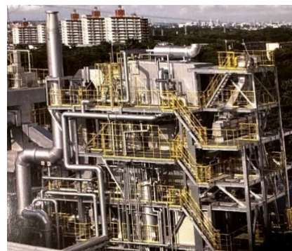
バイオマス発電設備
